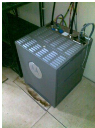
Estação Base Equipamento rádio
