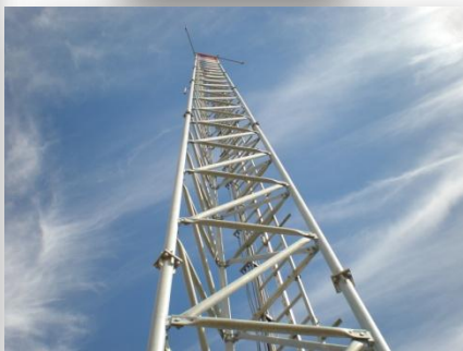
Torre (20-30m) com 2 ou 3 antenas
