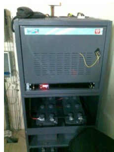
Estação Base Alimentação de emergência
